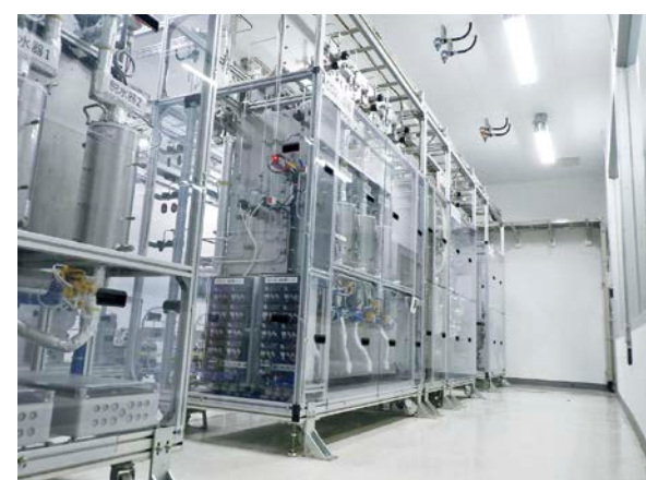
図6 メタネーション装置 (高浜工場) Fig.6 Methanation Equipment (Takahama Plant)
