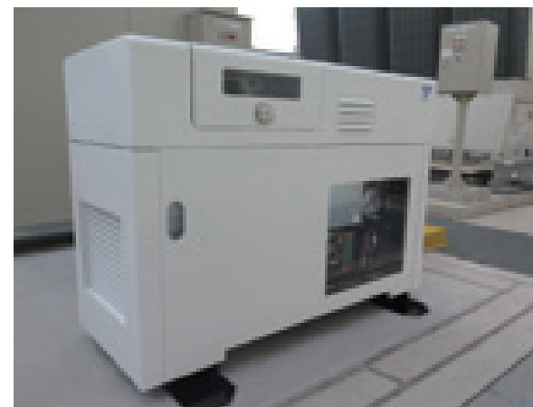
図2 FC発電機 Fig.2 fc generator
