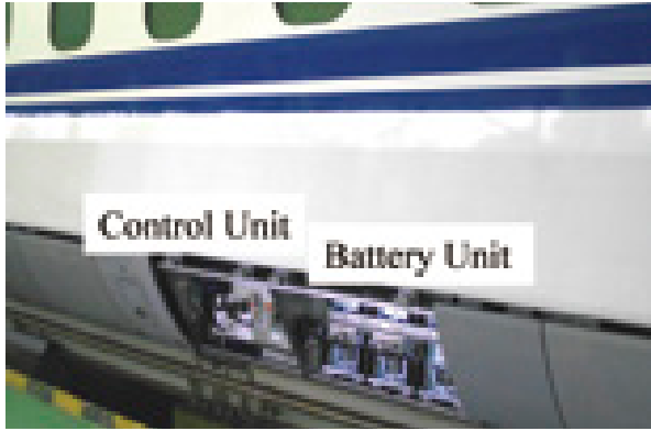
図12 バッテリー自走システム
