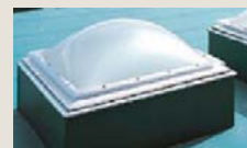
光ダクト採光口
