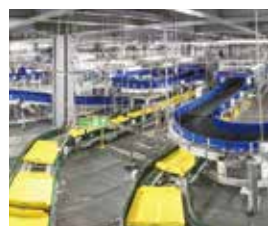
手荷物搬送システム (ヒースロー空港)
