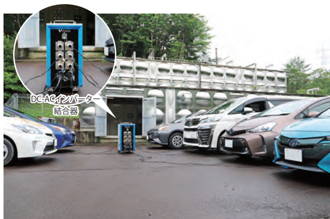
▲DC-ACインバーター結合器を活用した配水ポンプ稼動の実証実験
