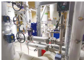
空調システム
