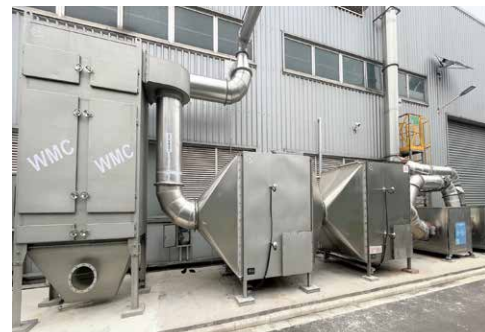
VOC収集処理設備
