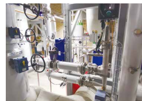
空調システム
