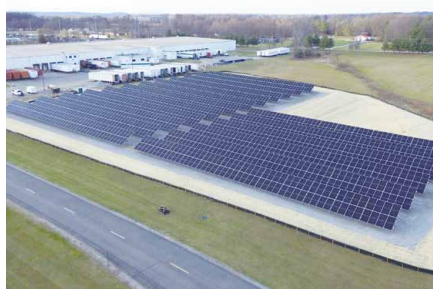
設置した太陽光パネル
