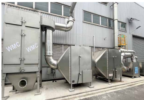
VOC収集処理設備
