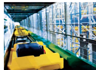
空港手荷物処理(バゲージハンドリング)システム
