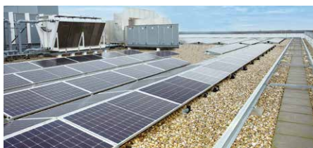
ファンダランデ社が建屋屋上に設置した太陽光パネル
